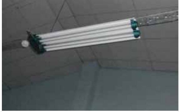
4.22 Exproof Aydınlatma Sistemi ve Duman Algılama
