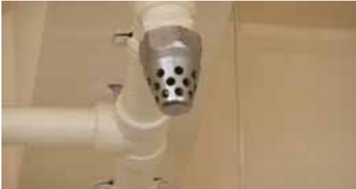
4.31 Yangın Algılama Sistemine Bağlı Çalışan Springler
