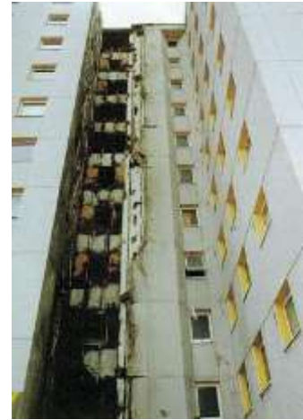
Şekil 3. Knowsley Heights, Liverpool, 1991, Cephenin geometrik yapısı nedeniyle baca etkisi oluşmuş, cephe kaplamasının yanıcılığı yangını destekleyerek üst katlara yaymıştır. [4].
