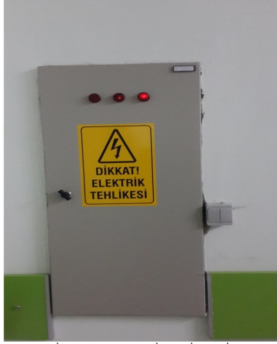
ELEKTRİK PANOSU YENİ HALİ (RESİM 5)
