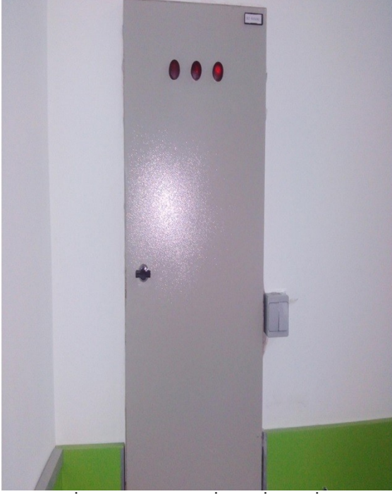
ELEKTRİK PANOSU ESKİ HALİ (RESİM 4)
